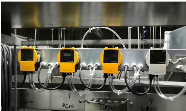
Foto: SAUTER Differenzdruck-Messumformer (EGP 100) zur Raumdruckregelung und -überwachung, installiert in der Impfstoff-Produktionsanlage von Sinopharm
